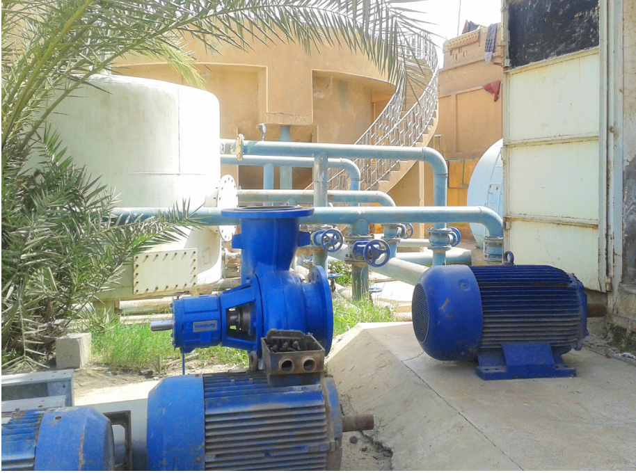
محطة مياه في القوربة
